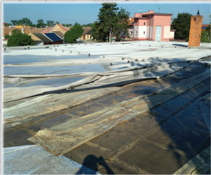
Poškozená střecha na naší prodejně v Hruškách
